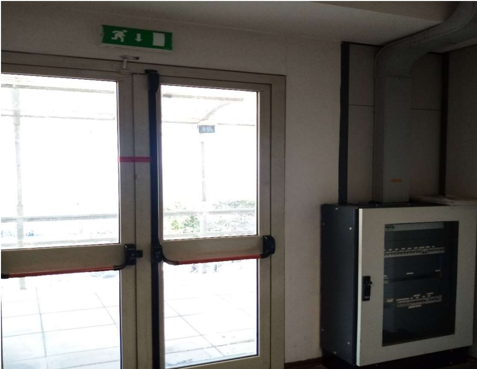
F.06 -07: Veduta di Infisso Porta in prossimità del Quadro Elettrico Generale
